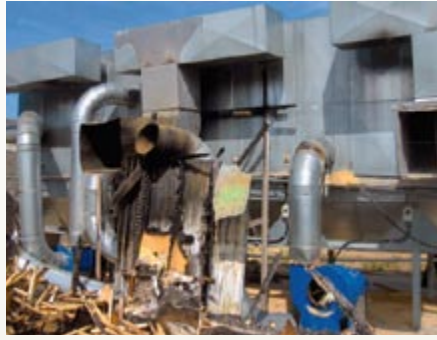
Kuva 3. Keskellä mustuneena puruputki, joka sisältä tullut räjähdys syytti läheisen hallin H2 räystäään. Kuvan ottopaikka on esitetty nuolikuviolla 3 kuvassa 1.
