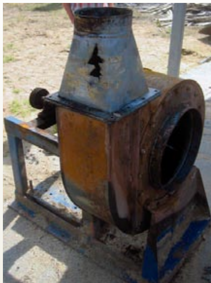
Kuva 2. Pölyräjähdys syntyi tässä tukkeutuneessa puhaltimessa.
